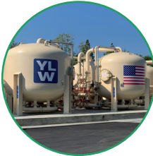
PFAS-Reinigungsanlage für Trinkwasser von Tetra Tech mit Umkehrosmose und Nanofilter.
